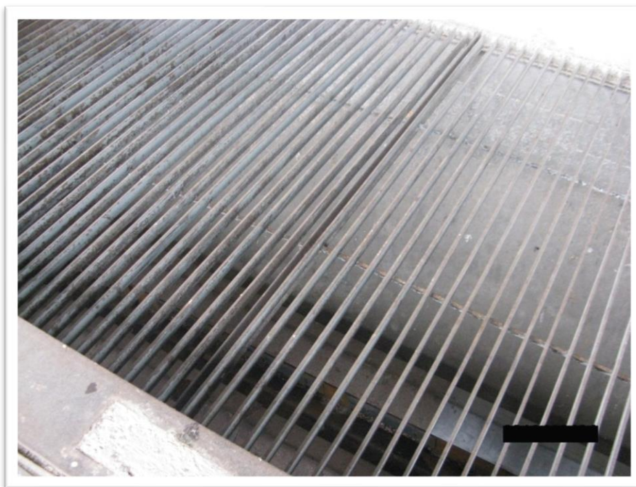
Megfelelő rácsozatú beömlőnyílás.
