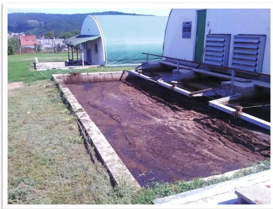
A hígtrágya tároló 3,0 – 3,5 m mély, beesés elleni védelem nincs kiépítve.
