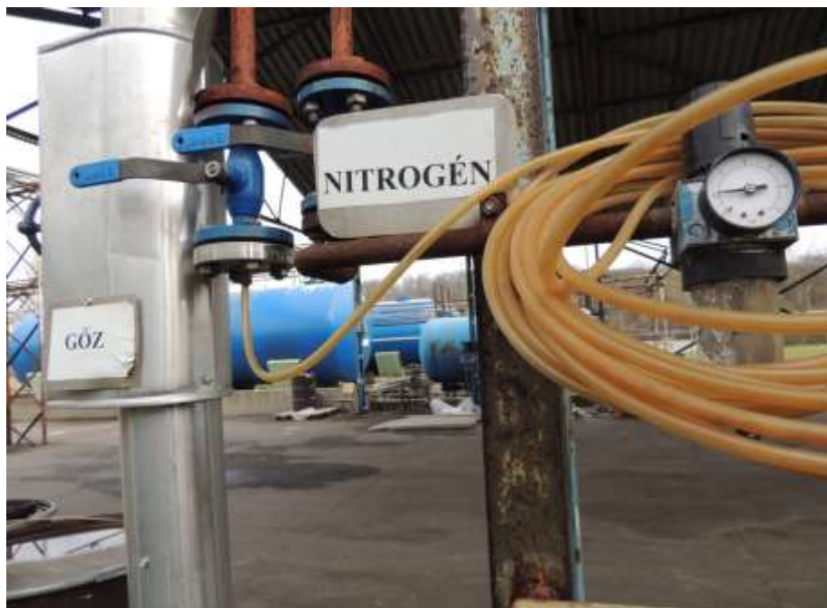
A nitrogén hálózat csatlakozása (munkavédelmi hatóság felvétele)
